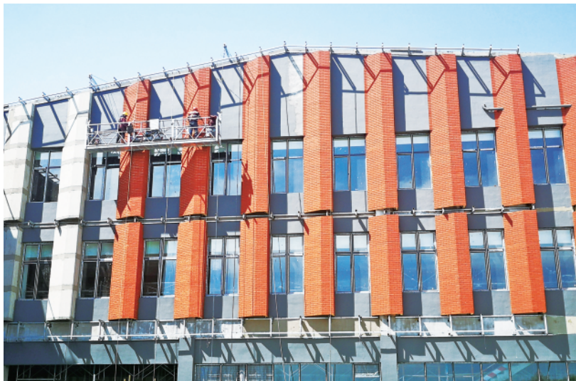
对外经贸大学青岛国际校区食堂正在进行施工。 □记者 梁玉鹏 报道
