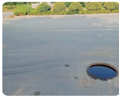
道路中间缺失井盖的古力井。
