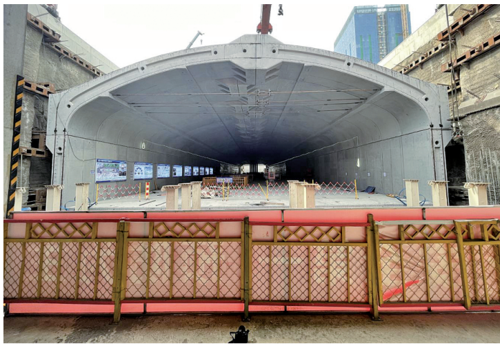
青岛地铁6号线可洛石站。
