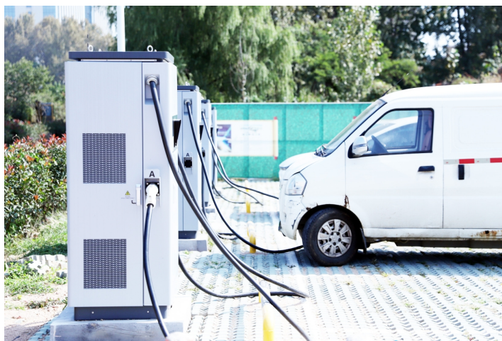
村庄新安装的充电桩已经投入使用。
