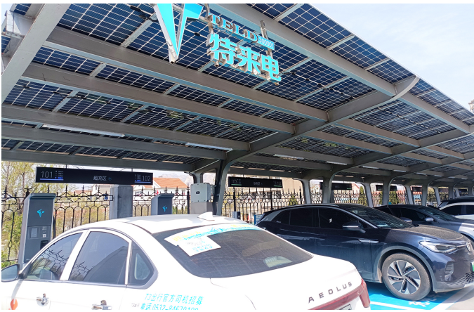
超充站顶棚布满分布式光伏发电系统。 □记者 祁璟 摄
