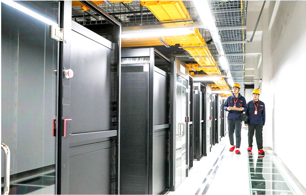
智算中心工作人员在机房巡检。
