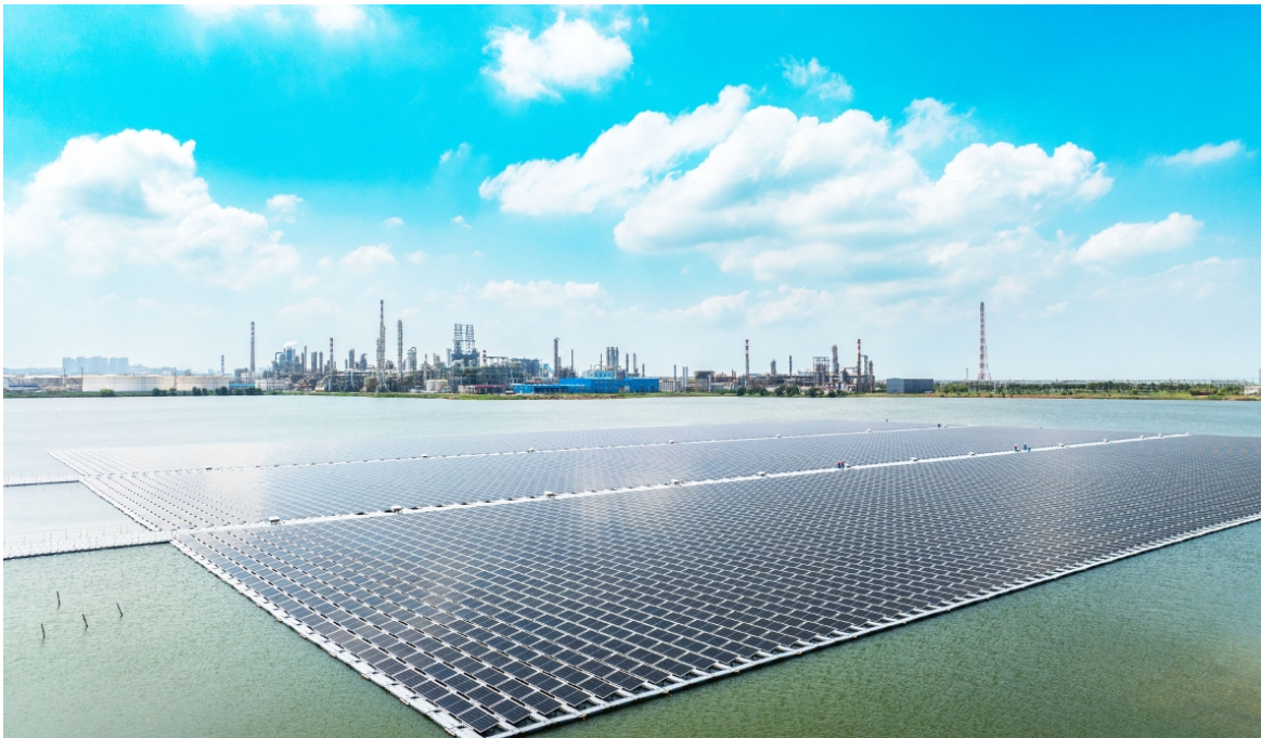
▲项目占地面积约60000平方米，具有零排放、效率高、成本低等优势。(青岛炼化供图)
